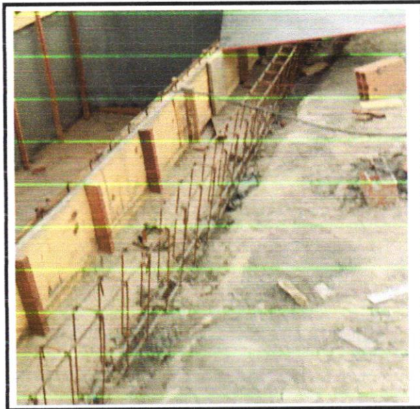
FOTO 16-ARMAÇÃO DE PILAR OU VIGA DE UMA ESTRUTURA CONVENCIONAL DE CONCRETO ARMADO EM UMA EDIFICAÇÃO TÉRREA OU SOBRADO UTILIZANDO AÇO CA-50 DE 8,0 M
